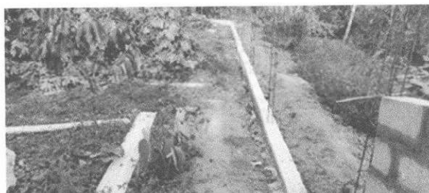
Foto 2: Se observa la parte sur de la esquina del predio del módulo 2, se esta en construcción necesita muro perimetral
