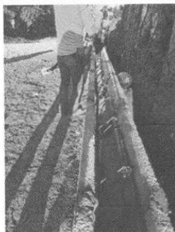
Foto 1: Se observa la parte de la calle principal del predio del módulo 2, esta en construcción se necesita muro perimetral
